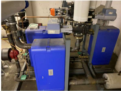
Våra 3 st. Fjärrvärmeväxlare
